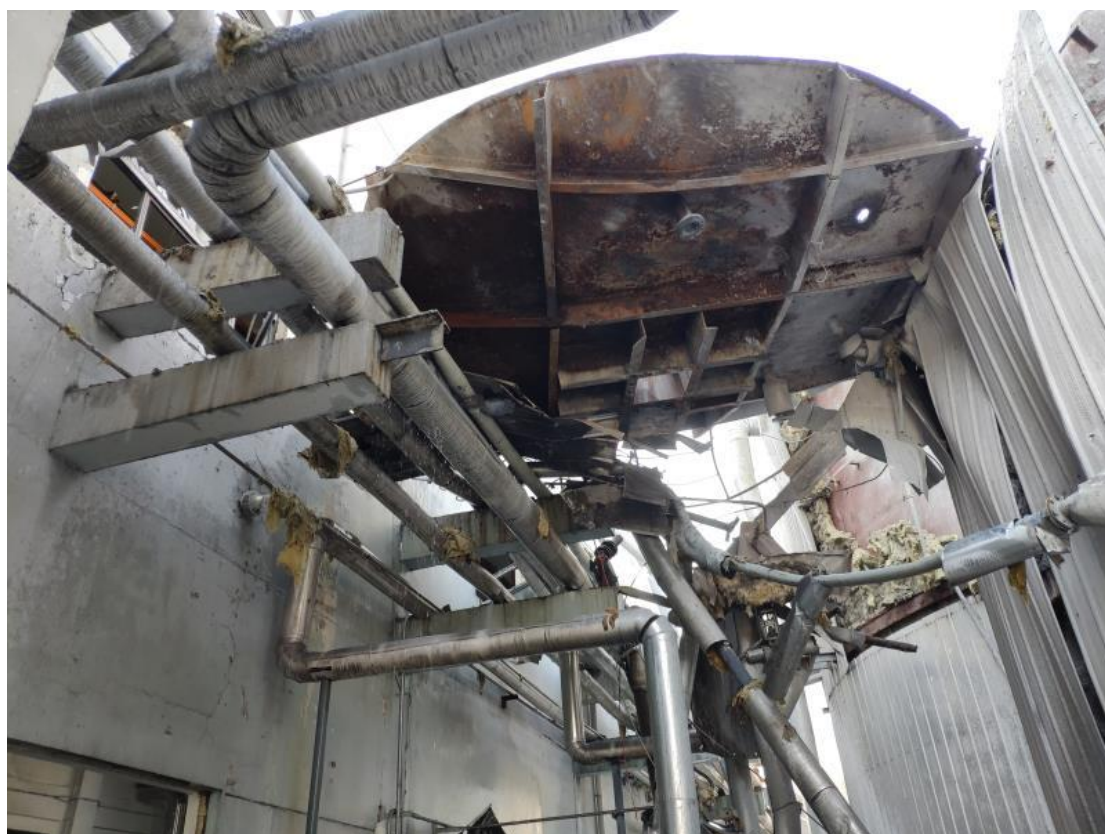
图 7 事故后现场图片
