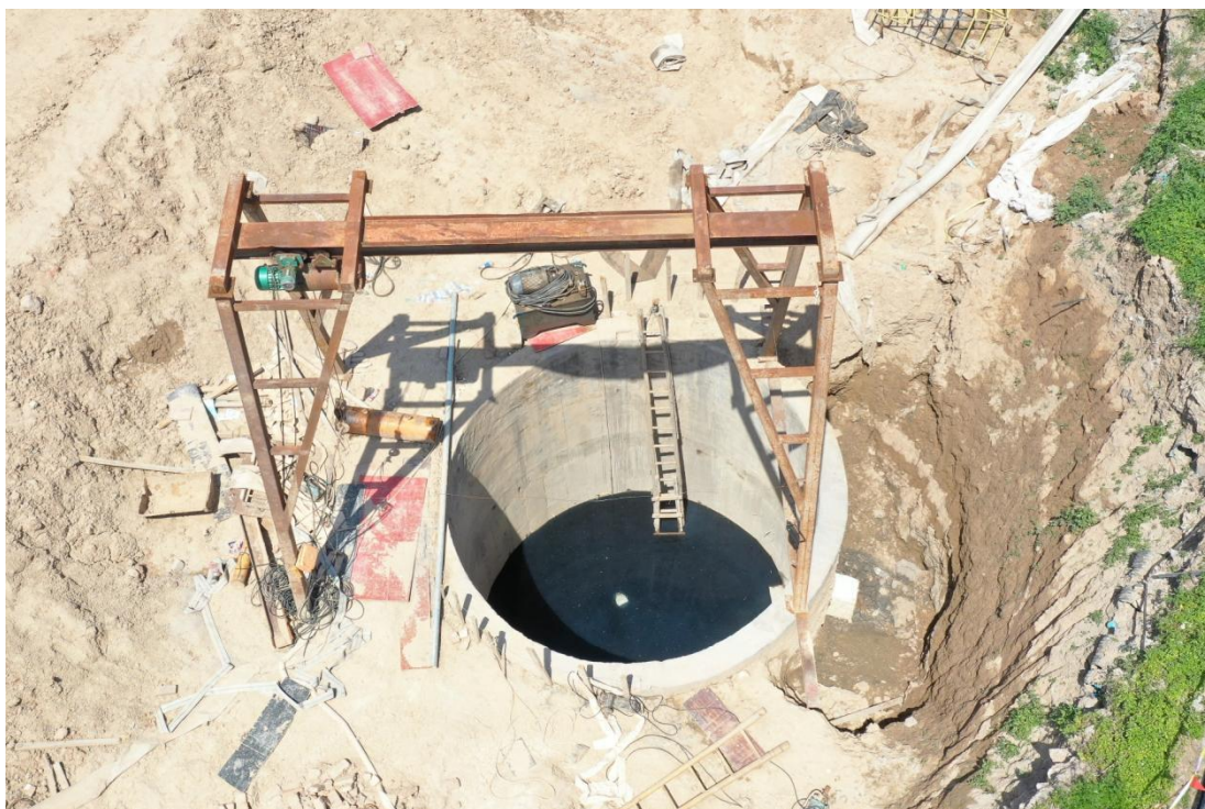
图5 事故井现场图
