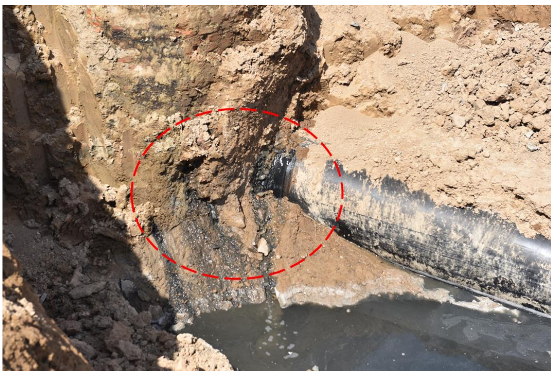
图 10 原检查井 1 与更换后的污水管道连接处漏水点
