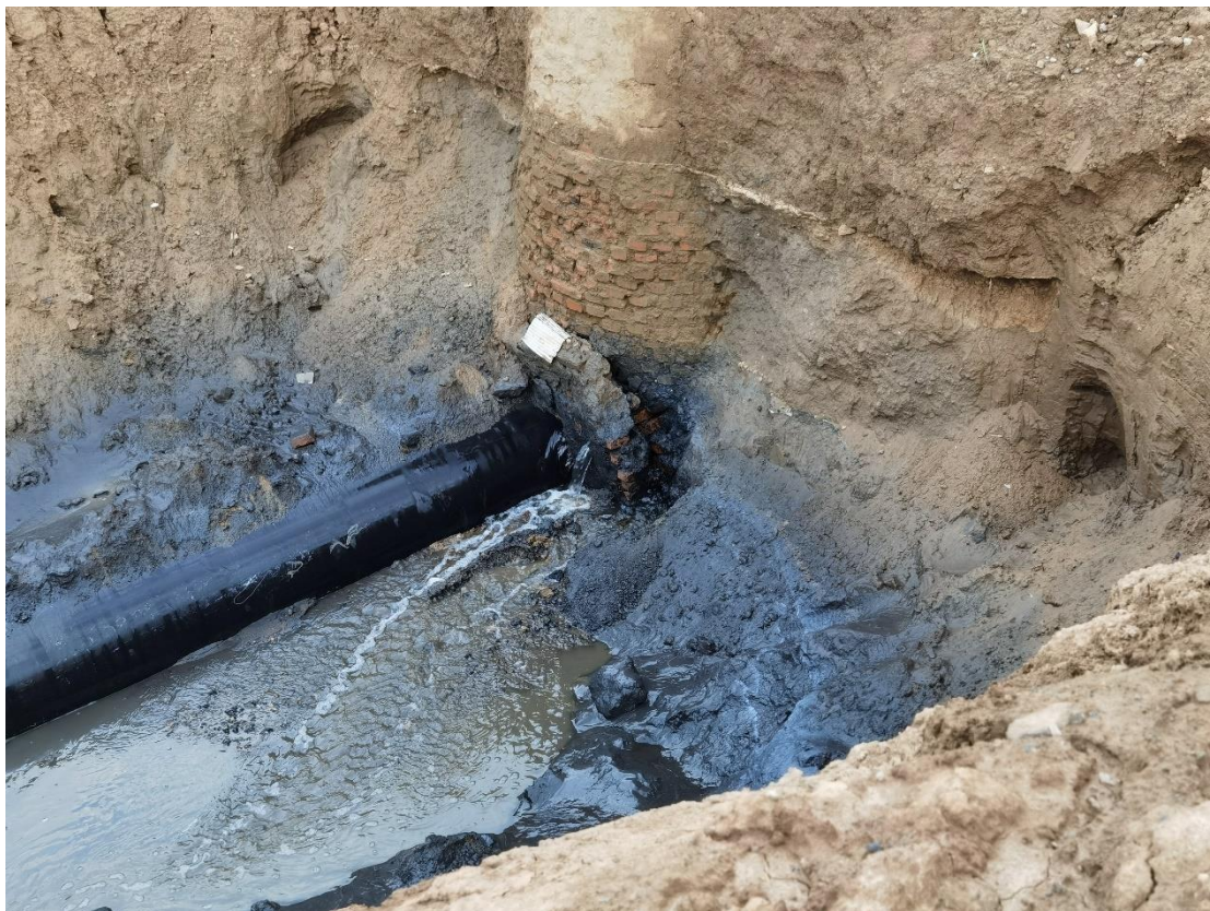
图 9 原检查井 2 与更换后的污水管道连接处漏水点
