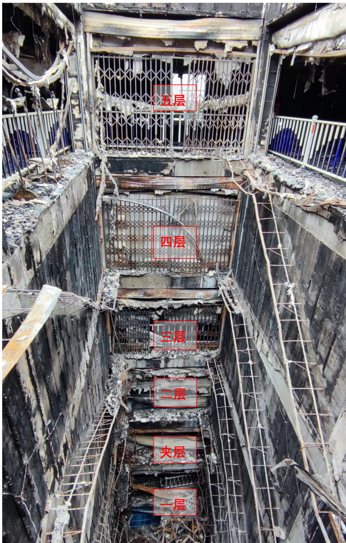
图 17 一至五层扶梯井过火后
