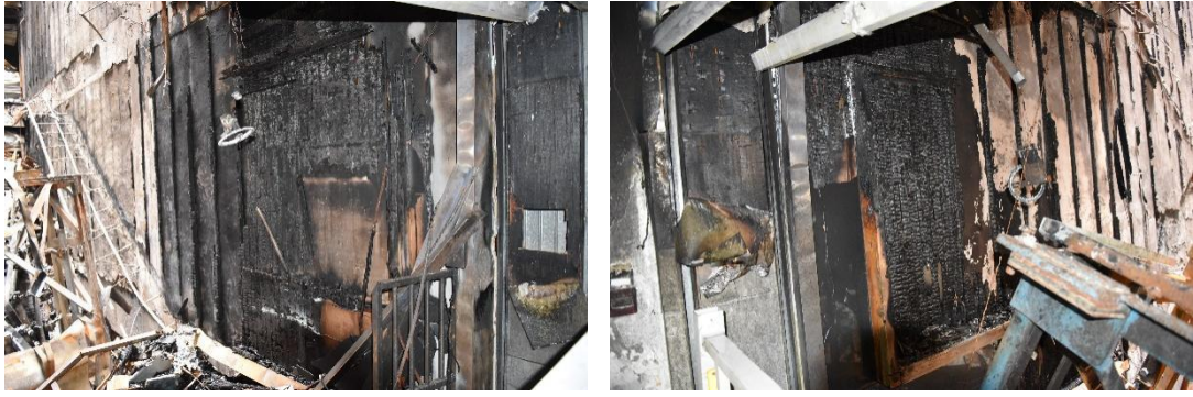
图 15 扶梯井东西两侧残留大量木质燃烧残留物
