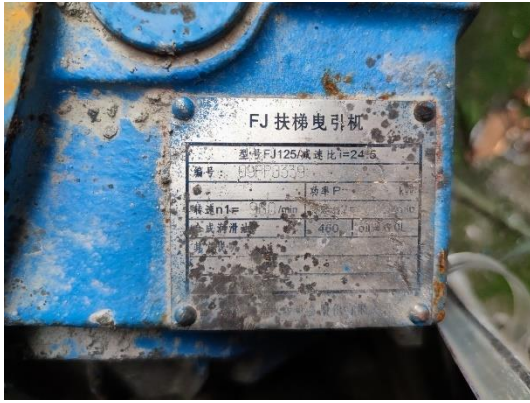
图 19 扶梯减速箱铭牌
