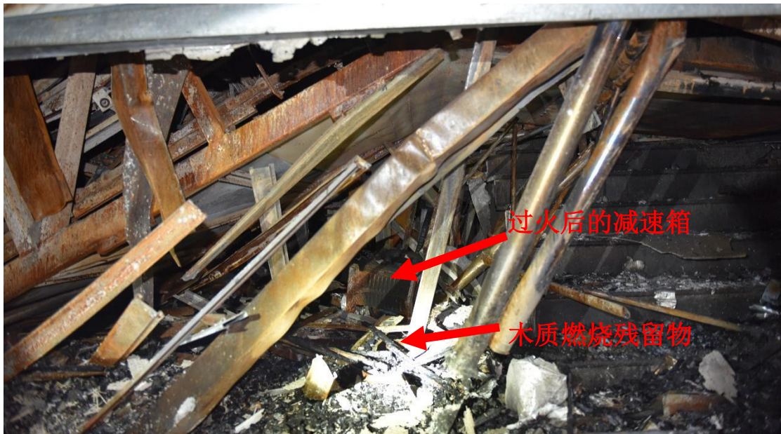
图 16 负一层地面有木质材料燃烧残留物和过火后的减速箱
