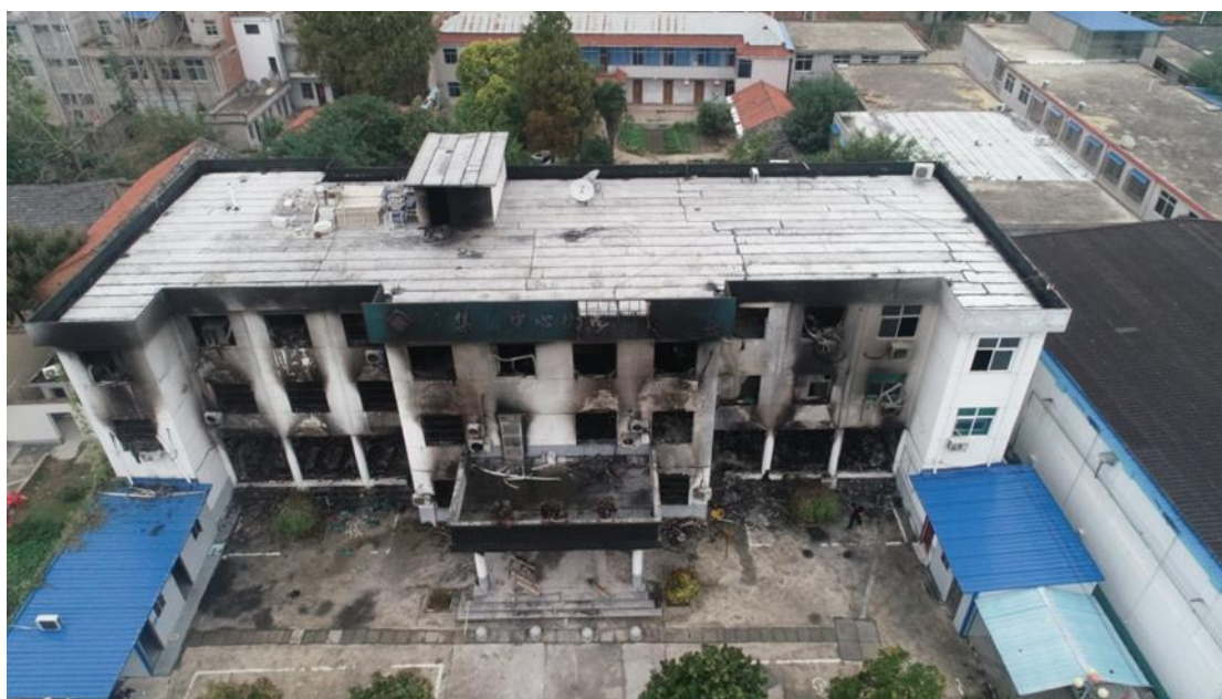
图 12 事故卫生院住院部综合楼火灾后概貌
