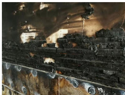
图 10 病房墙面木工板过火后碳化图
