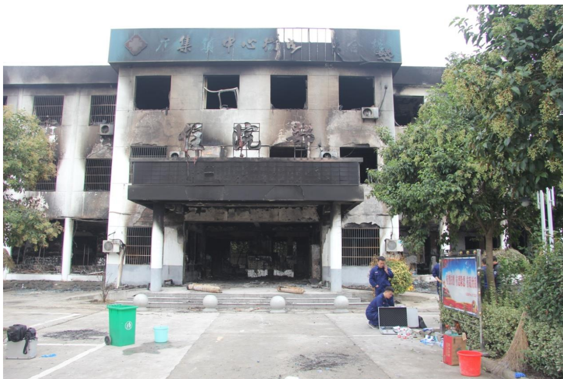
图 6 事故卫生院住院部综合楼正面大厅火灾后现状图
