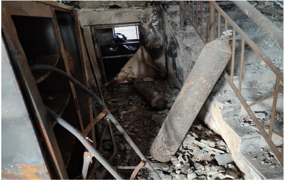
图 11 一层楼梯间底部空间设置氧气站存放氧气瓶
