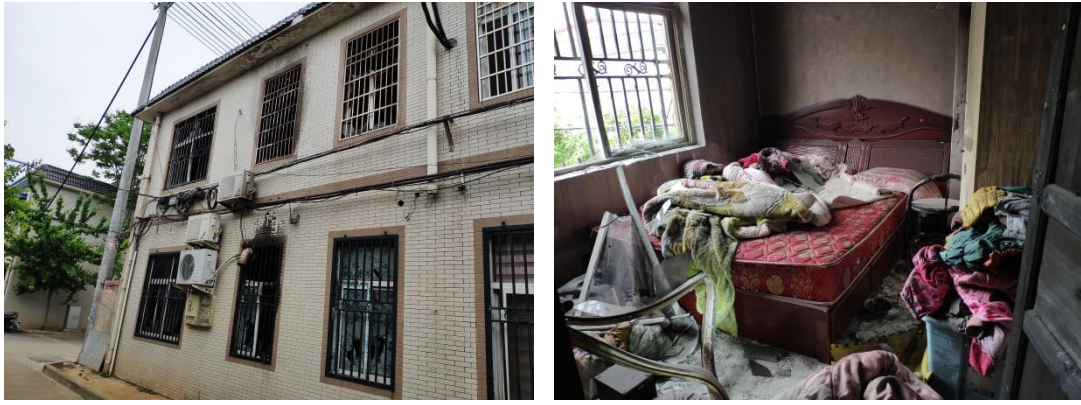
图 7 事故房屋北侧窗户均被安装防盗窗
