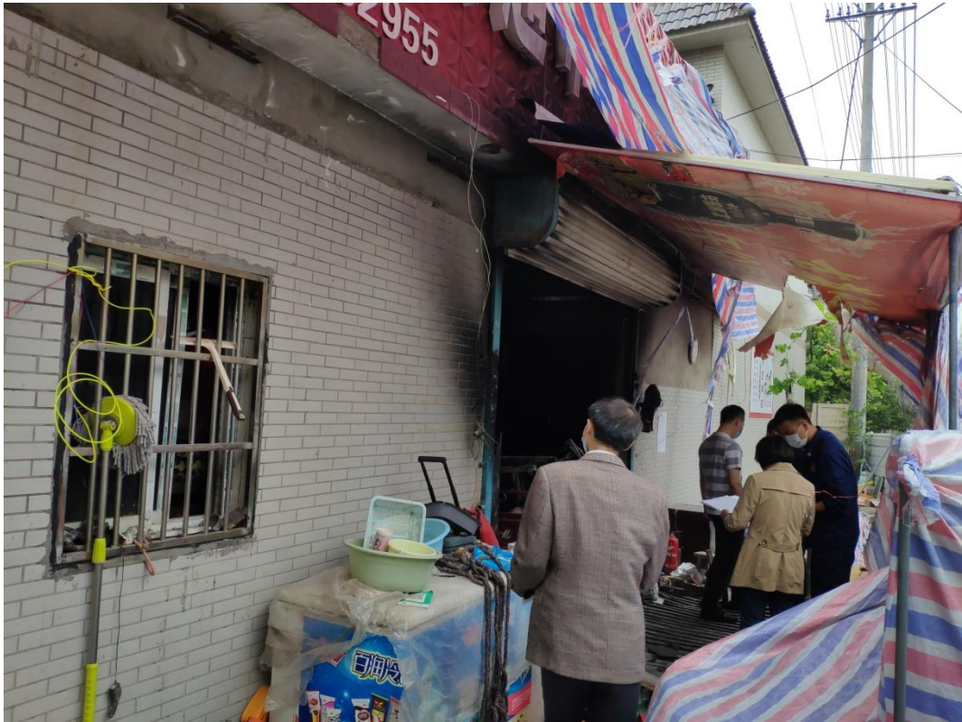
图 5 事故店铺火灾后外观图
