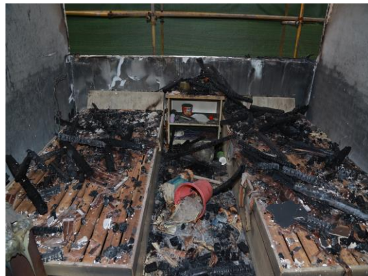
图 13 万泉旅社北面客房内过火后
