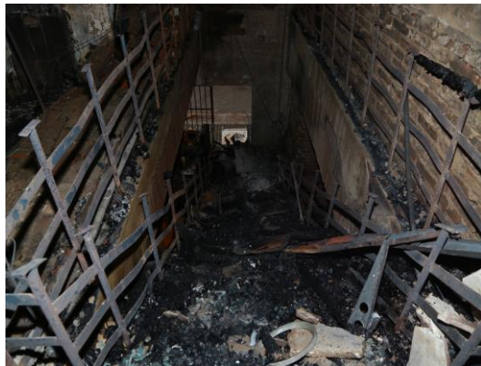
图 12 万泉旅社西侧楼梯被封堵
