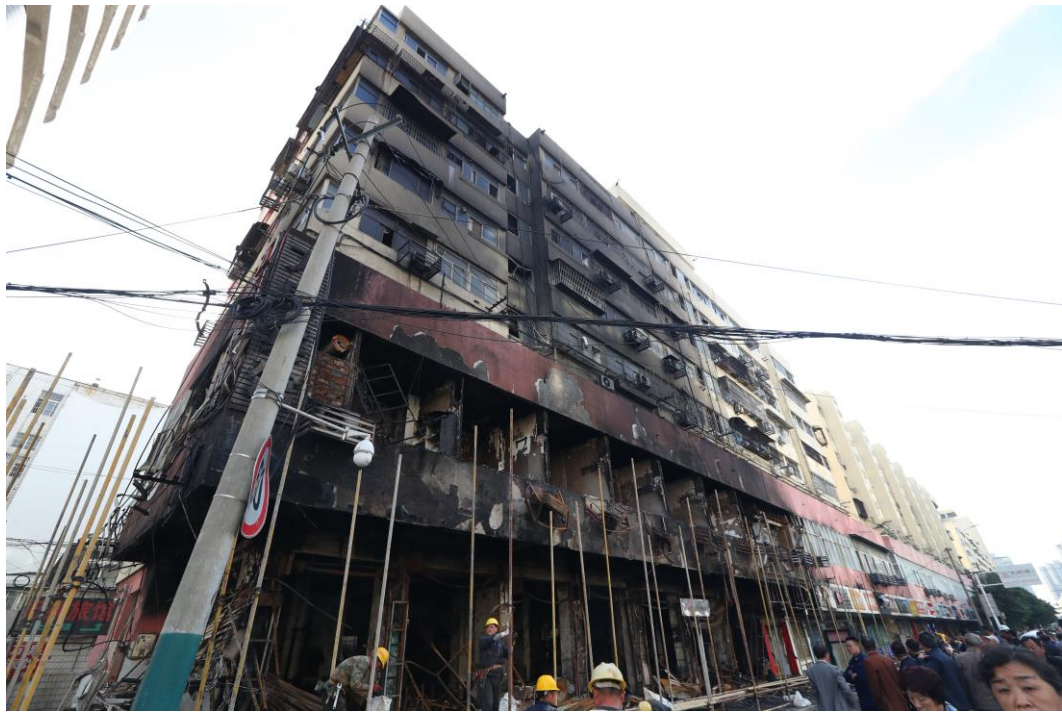
图 11 事故建筑北面火灾后现状图
